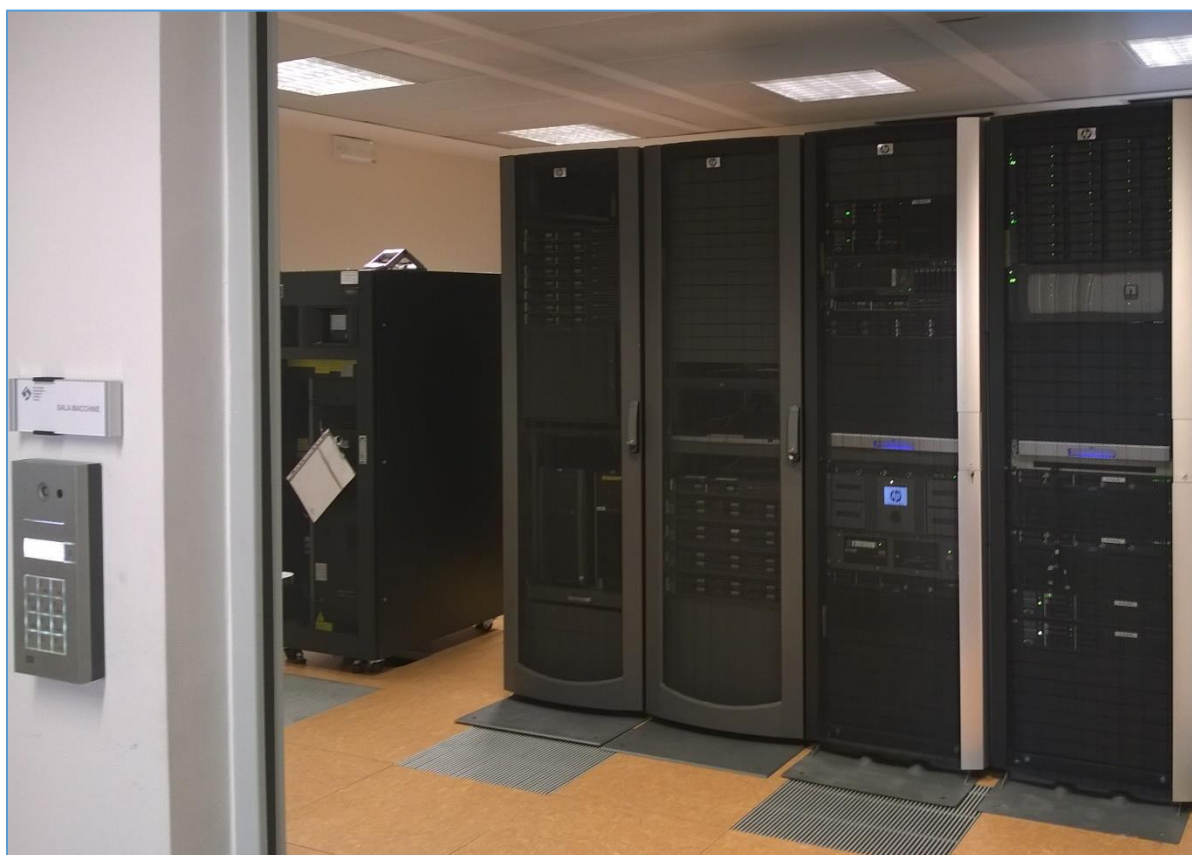
Figura 4 – Scorcio della Sala Macchine di 5T
